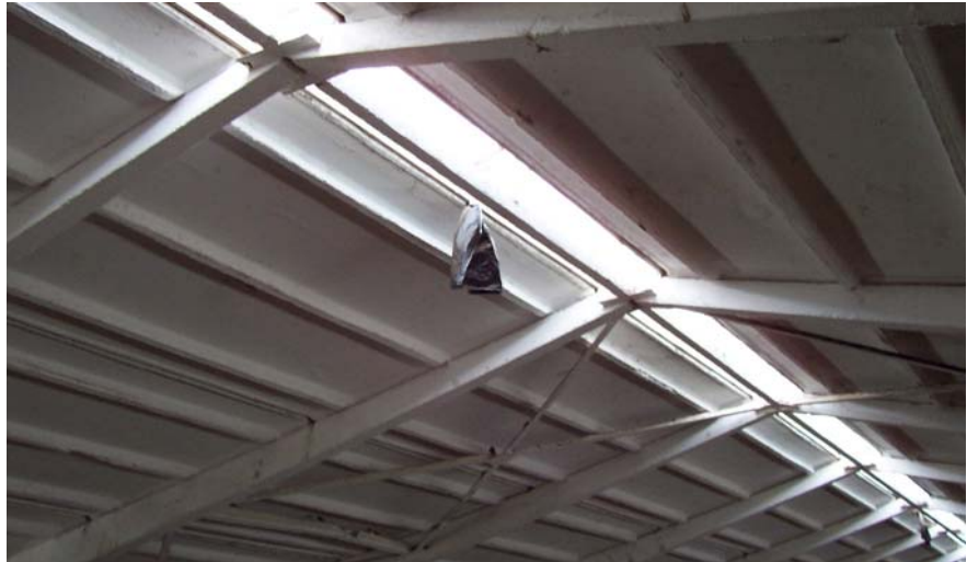
Рис.2. Світовий вентиляційний отвір крівлі, як елемент створення мікроклімату тваринницького приміщення.
